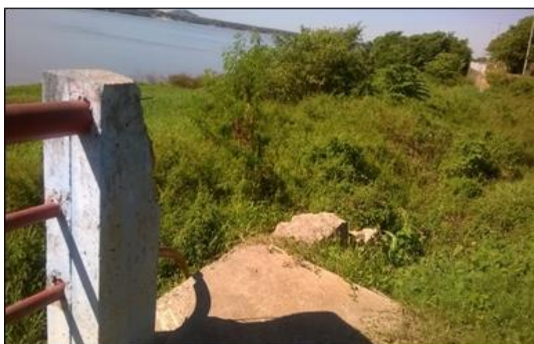
Figura 4. Obra mal estruturada no Beiradeiro.
